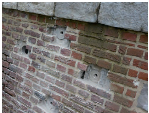
Nichoirs artificiels intégrés au parement et maintien de fissures auxquelles les chauves-souris sont sensibles.
